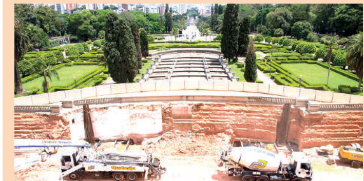
Prédio apresentava rachaduras e umidade nas paredes
