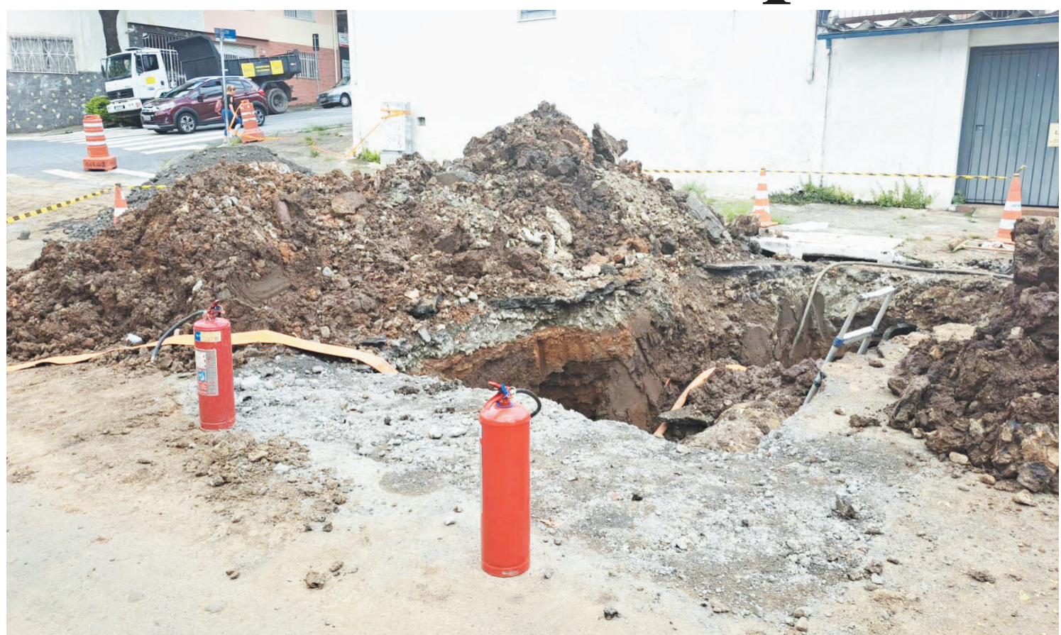
Por volta das 10 horas desta terça-feira (7), um trabalho da Prefeitura com retroescavadeira para manutenção de rede de esgoto, acabou causando avaria em uma rede de gás na Cisplatina, altura do número 425. PÁGINA 2
