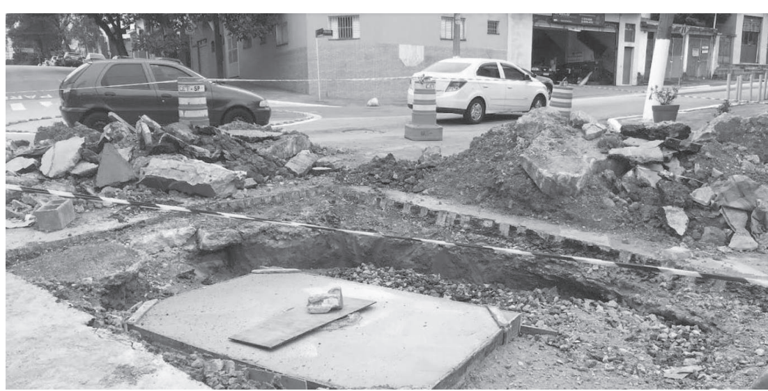
A subprefeitura do bairro informou que até o final dessa semana as obras serão finalizadas parte da via. Até agora, parte da cratera foi preenchida e, também, construída uma passagem para água no buraco. A subprefeitura disse que a previsão é que até o final da semana as obras estejam concluídas e o trânsito normalizado.
