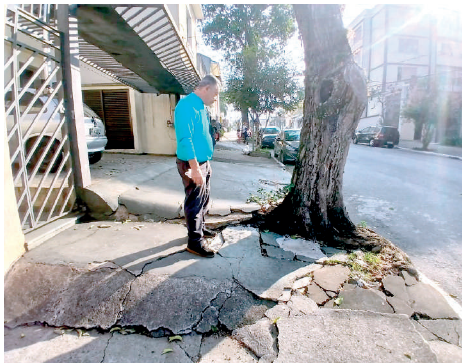
Luis Carlos tem uma propriedade na Rua Clemente Pereira e vive o drama das calçadas quebradas. O mesmo acontece na Rua Campante, 750, na Vila Carioca
