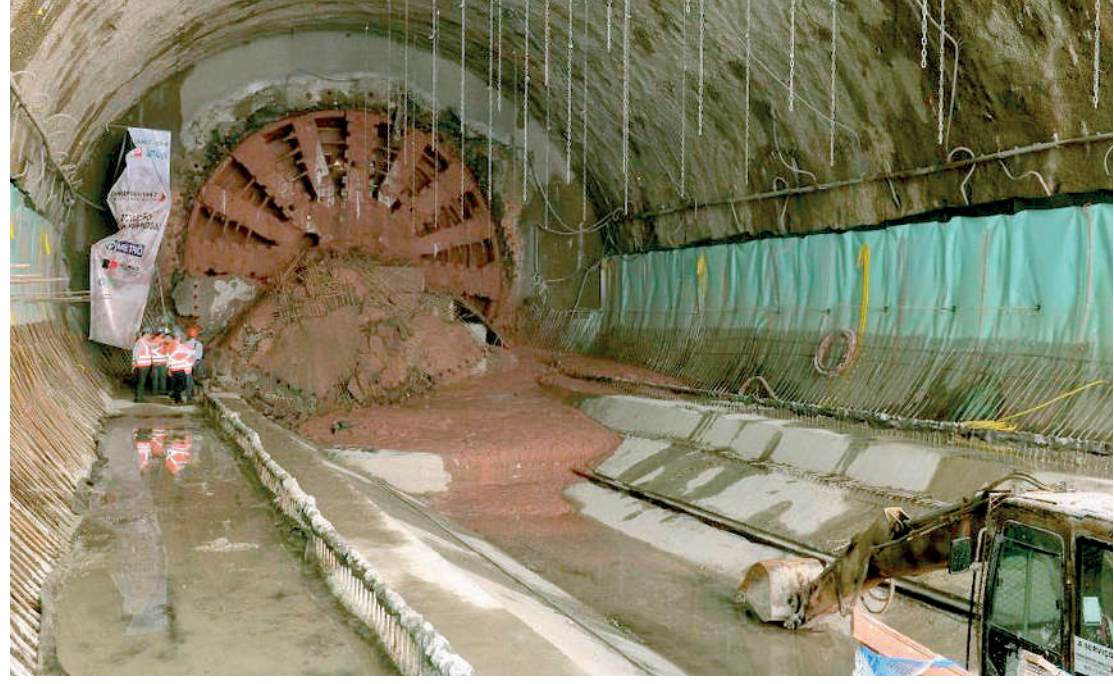
As obras de expansão da Linha -2 Verde do metrô estão em ritmo acelerado e avançando em direção à Penha. O Tatução, a maior tuneladora em atividade na América Latina chegou nesta quinta-feira (29) à futura estação Vila Formosa, na zona leste da capital. Com o novo trecho, o ramal passará a ligar a Vila Prudente à Penha. PÁGINA 3
