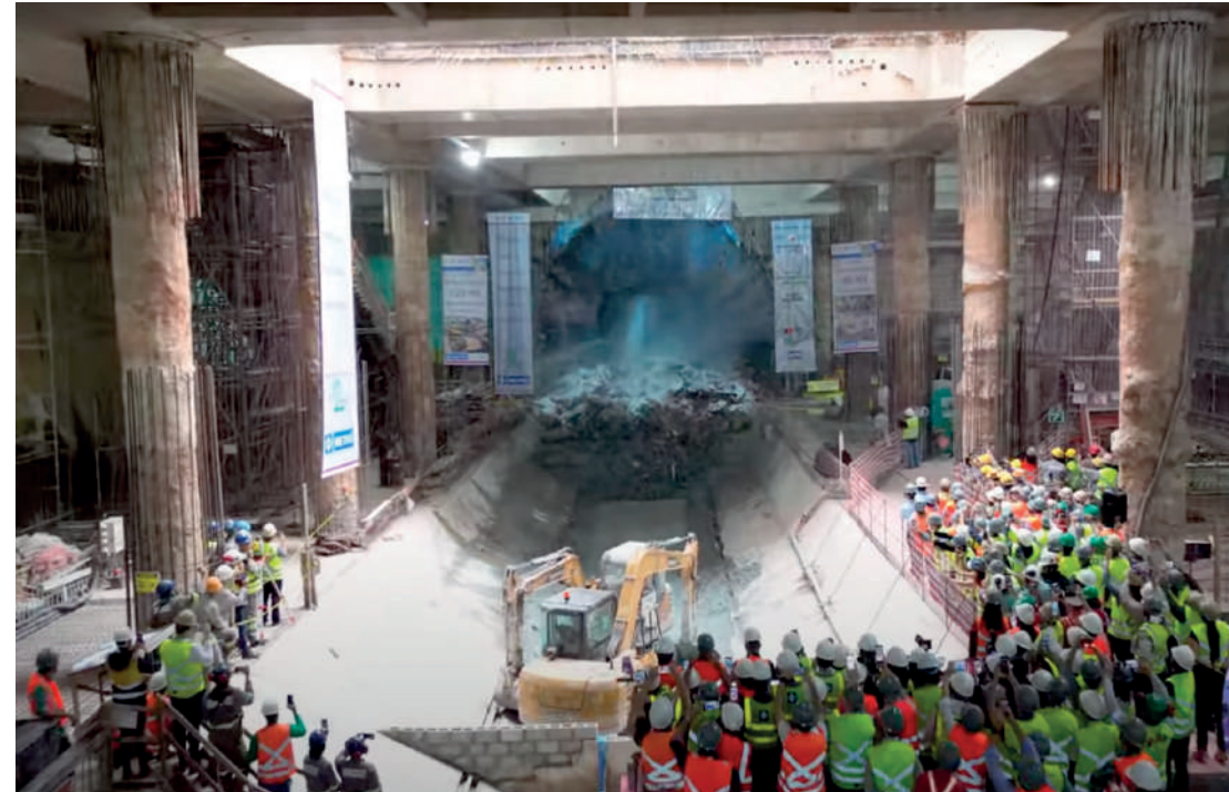
O maior Tatuzão da América Latina chegou nesta quinta-feira (27) à futura estação Anália Franco, concluindo mais um ciclo de construção dos túneis de ampliação da Linha 2-Verde do Metrô. PÁGINA 3
