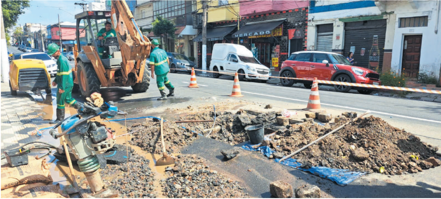
Representante da empresa alega que o problema foi pontual e a obra está sendo realizada para concerto de ramal de esgoto
